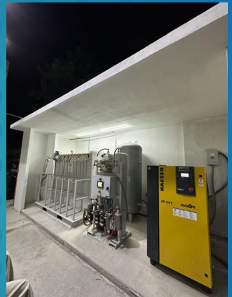
Equipo de generación de Oxígeno y relleno de cilindros, Cancún, México.
